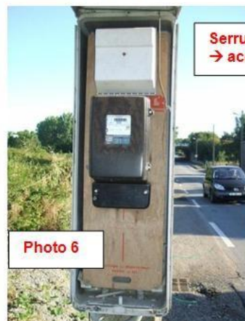
Coffret sur poteau, ouvert
